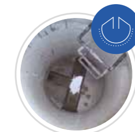
INSPECTIEPUTTEN. SYSTEMATISCH GESANEERD.
