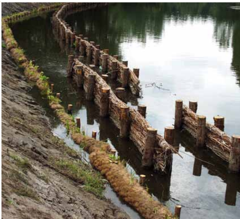
Foto: Moervaart: teenversteving (kokosrollen) en vooroevers (wiefen tussen houten palen). Belang: golfslag oever tegenhouden, zodat de vegetatie op de oever spontaan kan ontwikkelen. Via NTMB-zorgsysteem: o.a. gebruiks- en plaatsingshandleiding.
